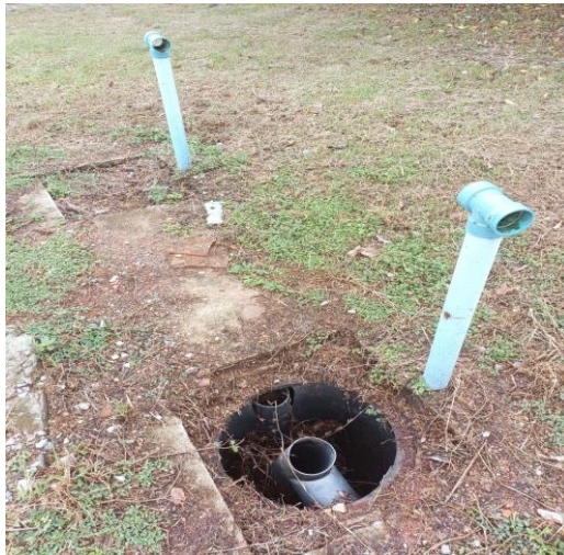
บ่อดักไขมัน
